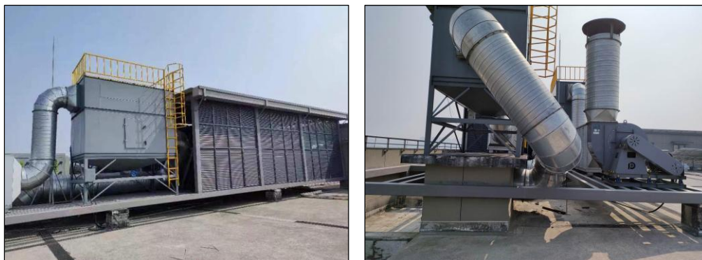
废气处理装置照片
